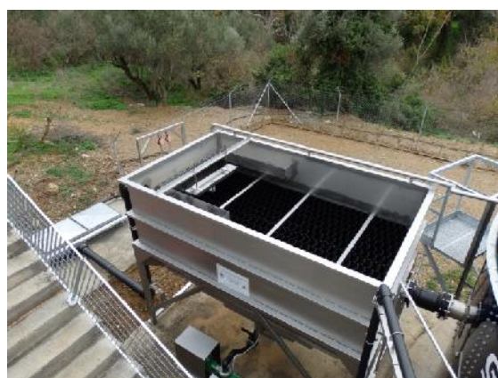
Καθίζηση με λαμέλλες.
