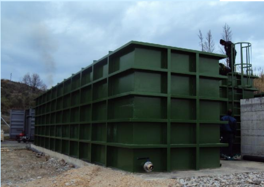
Δεξαμενή βιολογικής επεξεργασίας
